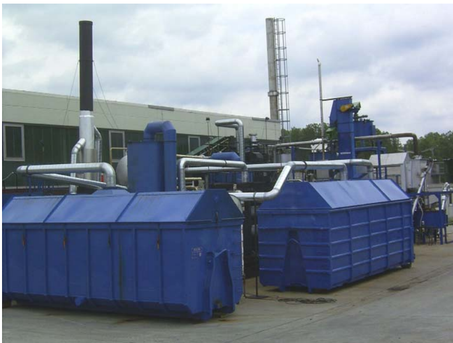
Abbildung 17: Biofilter; (Quelle: Pyromex AG)
