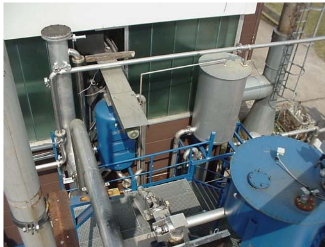
Abbildung 21: Gaswäscher einer Hochtemperatur-Entgasungsanlage; (Quelle: Pyromex AG)
