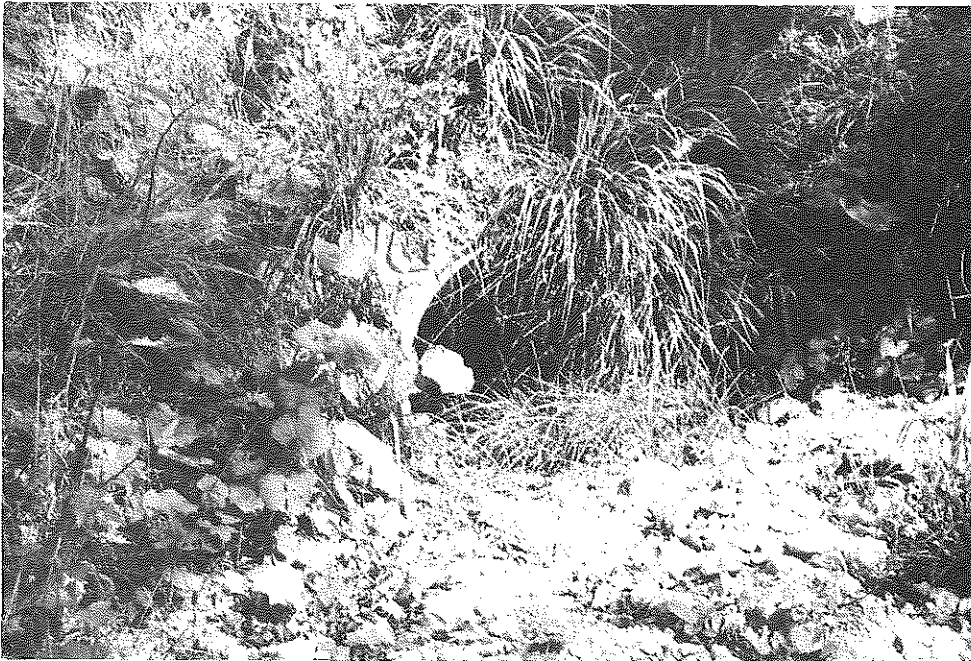
Abb.6: Stark eingeschütteter Rohrdurchlaß bei der Nordhang-Schlepplifttrasse
