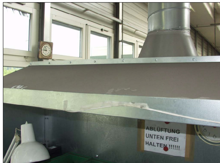
Abbildung 14: Arbeitsplatzabsaugung am Demontagearbeitsplatz (Quelle: EMPA, 2011).
