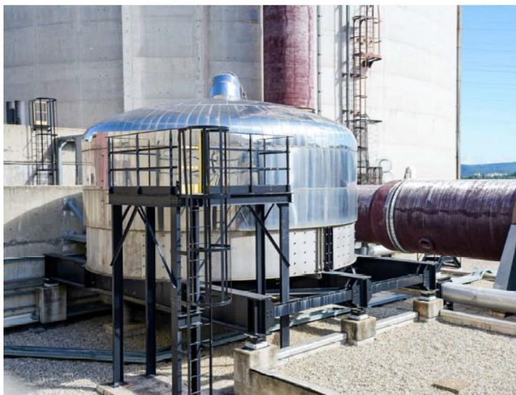
Figure 14. Photo du dispositif d'éventage et de filtration de l'enceinte (filtre U5)
