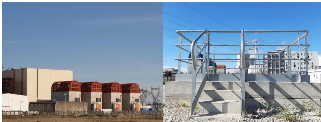
Diesels d'Ultime Secours (DUS) de 3 MWe
