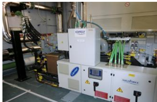
Nouveau groupe froid (+ 50% de capacité frigorifique)
