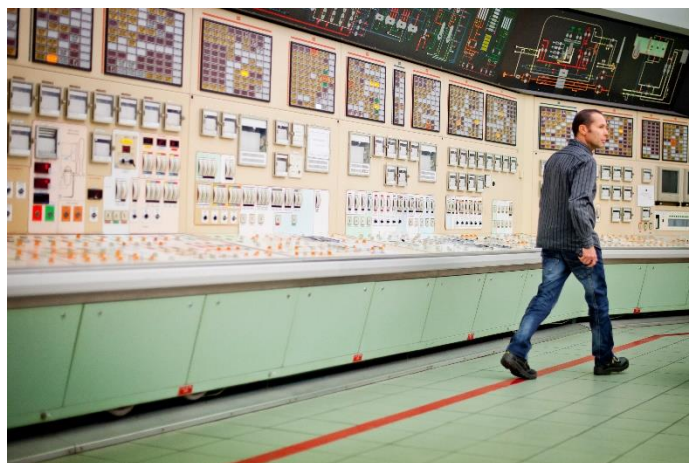
Figure 20. Salle de commande d'un réacteur 900 MWe (Copyright EDF / JAYET Stéphanie / TOMA)
