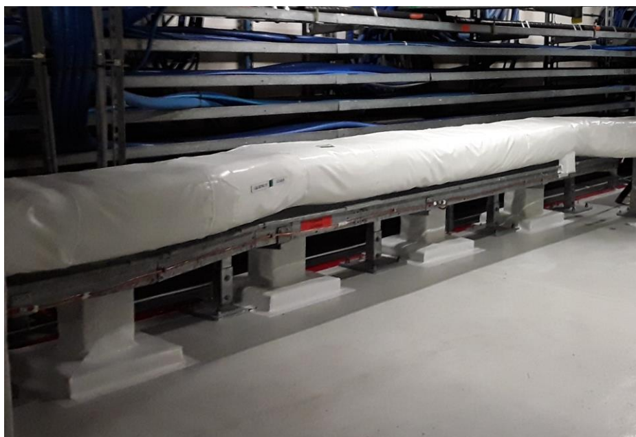
Figure 5. Exemple de protection de chemin de câble
