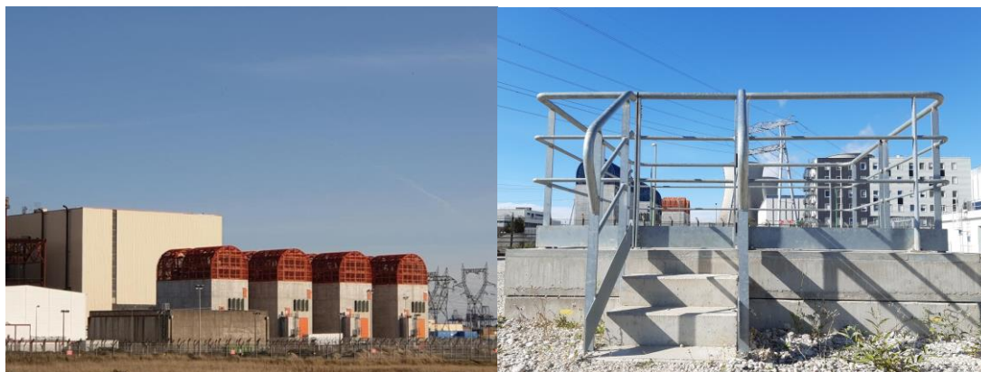
Diesels d'Ultime Secours (DUS) de 3 MWe
