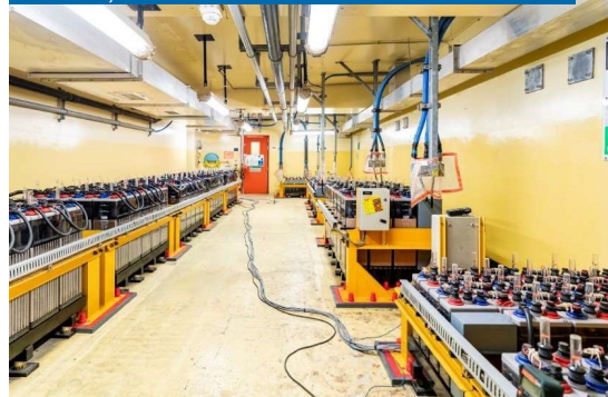
Räume, in denen sich die Batterien befinden
