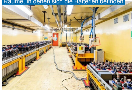
Räume, in denen sich die Batterien befinden
