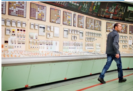
Kontrollraum eines 900-MWe-Reaktors
